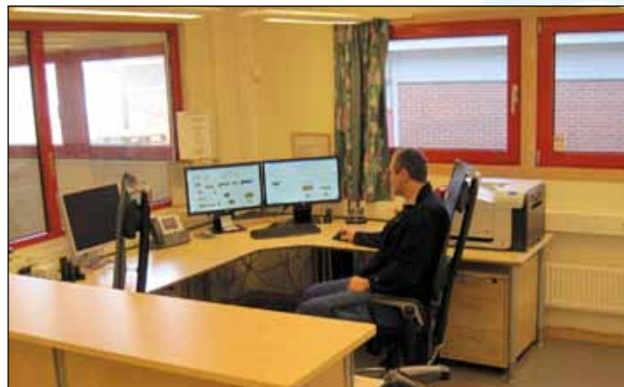
Nytt kontrollrom ifm utskifting av driftskontrollen ved Kambo Renseanlegg
