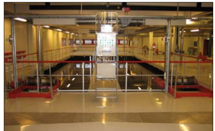
Sedimenteringsbassenghall ved Kambo Renseanlegg
