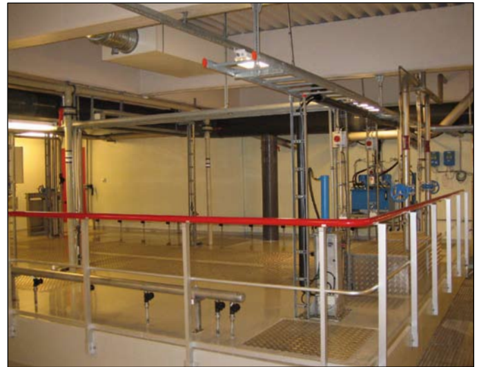
Bildet viser området hvor sand og flyteslam blir renset
