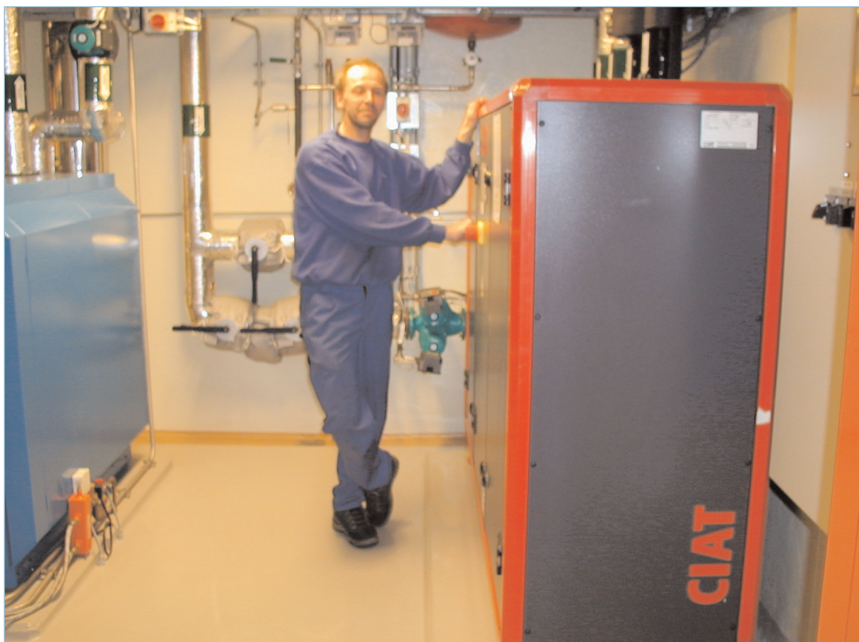
Driftsoperatør Eivind Madsen ved varmepumpe
